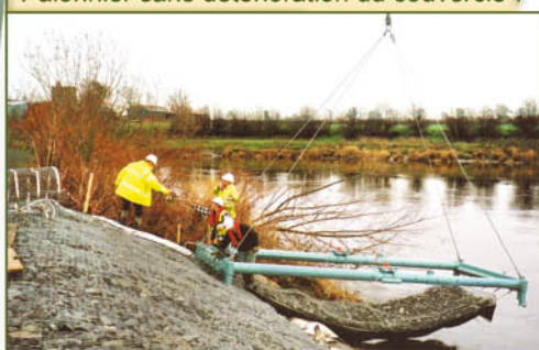
Palonnier sans détérioration du couvercle
